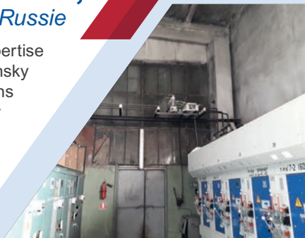
Distribution 6kV de l'usine d'Elets, projet en cours d'étude pour rénovation
