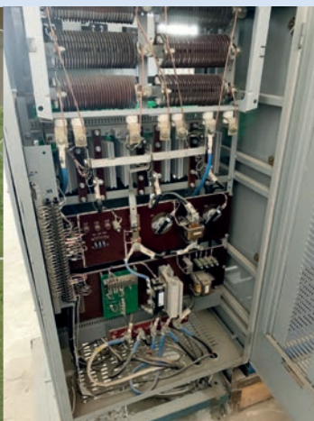
Excitation de Kaminski défectueuse et obsolète, pour laquelle nous avons réalisé une expertise
